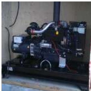
Nome Elektro AS stod for installasjon av strøm og backupgenerator.
