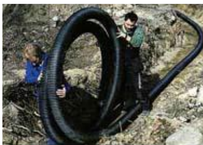
Bilde 3.3 Eksempel på PEX-rør
