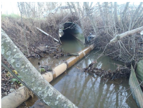
Bilde: Kloakkrør, oppgangshinder
