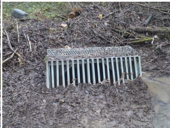
Bilde: Oppgangshinder, rist oppstrøms side
