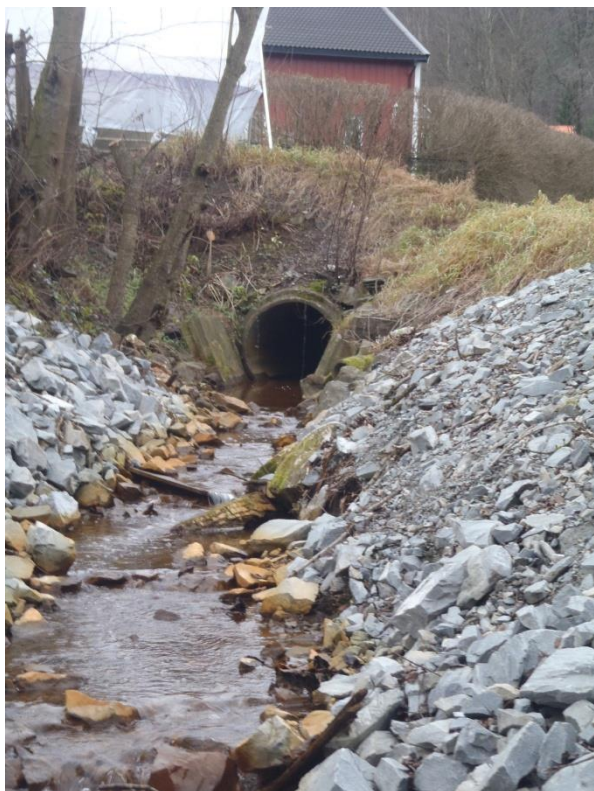
Bilder: Oppgangshinder, rør med ca 70 meter lengde
