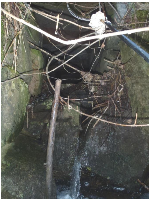
Bilde: Delvis gjenrast kulvert, oppgangshindrende effekt
