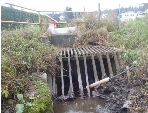
Bilde: Inntaksristtil rør, oppgangshinder
