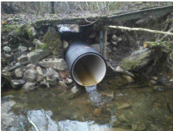
Bilde: Passasje under sti/traktorvei i nylig nedlagt plastrør med ikke optimal utforming.
