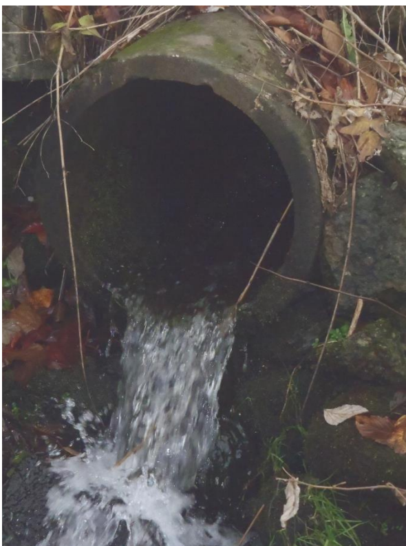
Bilde: Rør høyt i veifylling er oppgangshinder
